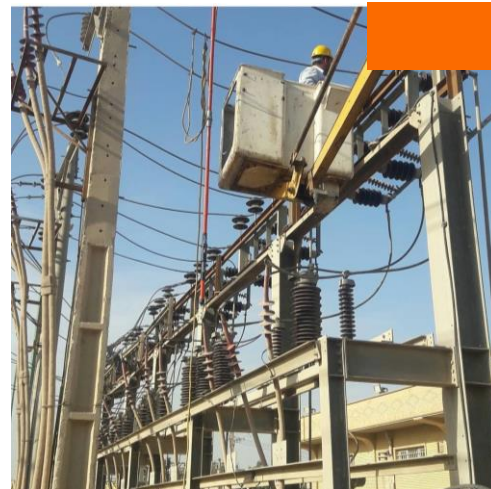
تعمیر و نگهداری ایستگاه برق خرمشهر
